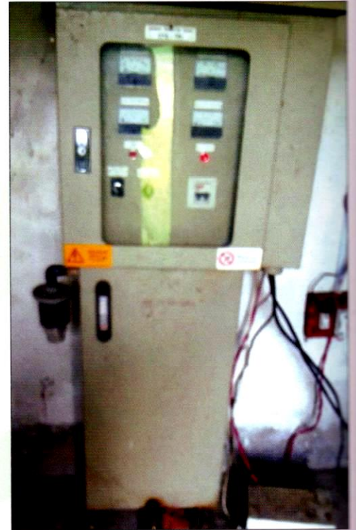
ক্যাথডিক প্রটেকশন (সিপি) সিস্টেম রুমে অবস্থিত সরঞ্জামাদি
